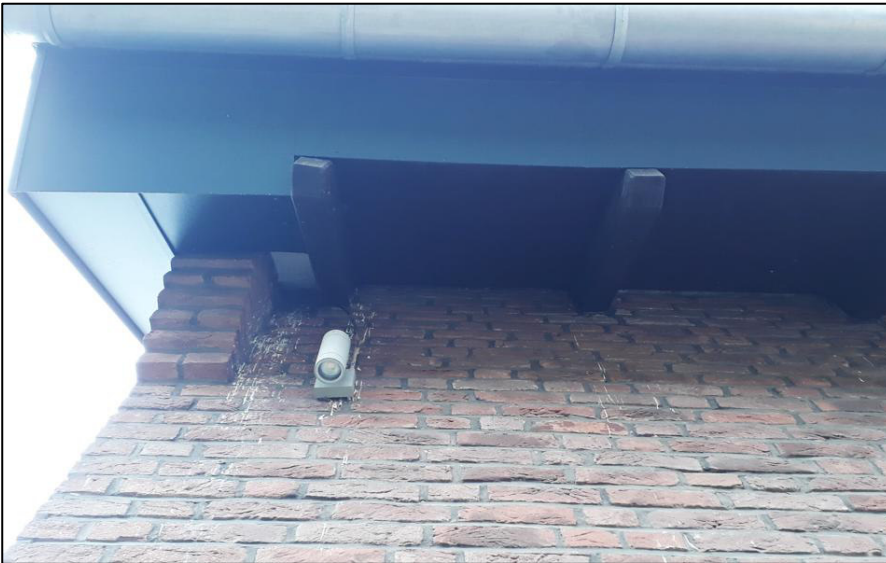
Abb. 7: Kotspuren am Wohngebäude im Traufbereich
